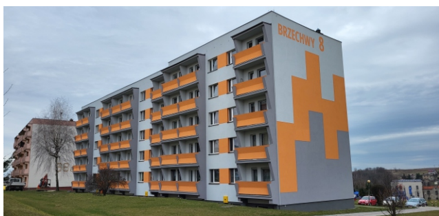
Budynek przy ul. Jana Brzechwy 8 po kompleksowej termomodernizacji przy wsparciu finansowym Banku Gospodarstwa Krajowego.
