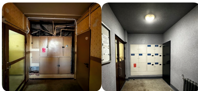
Stara i nowa rozdzielnia główna w wiatrołapie budynku przy ul. Skłodowskiej - Curie 99/1 - przed i po przebudowie.
