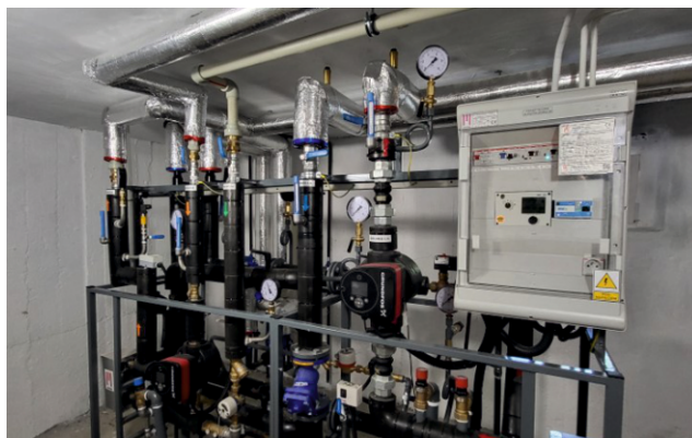
Wymiennik c.o., c.w.u. w budynku przy ul. Piotra Skargi 28.
